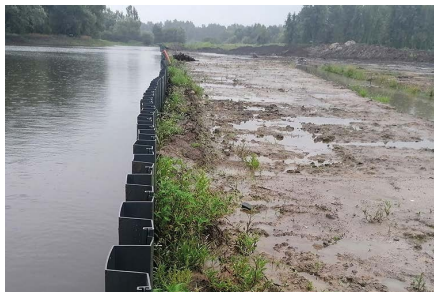
Defesa de margem: freia a socavação do pé de barranca
